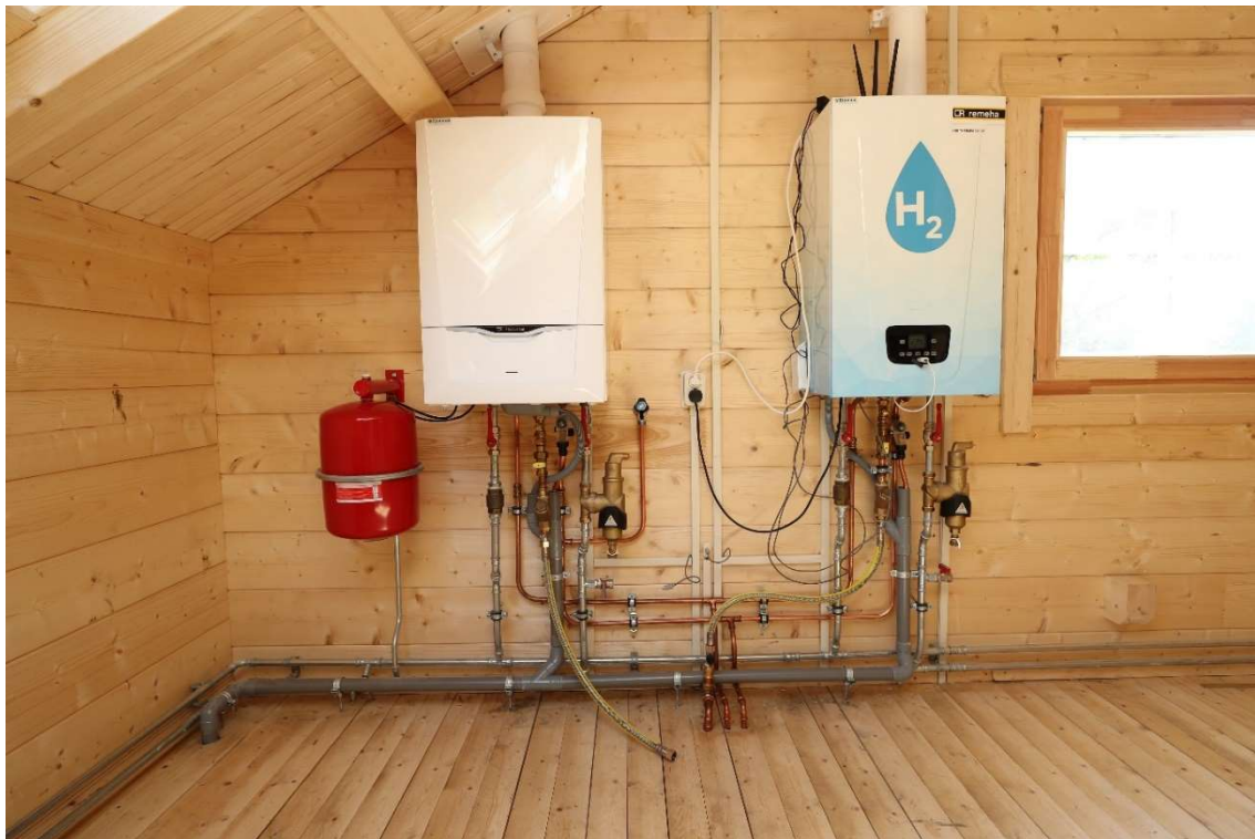
Figuur 3: Een waterstofketel (rechts) en een aardgasketel om de ombouw te trainen
