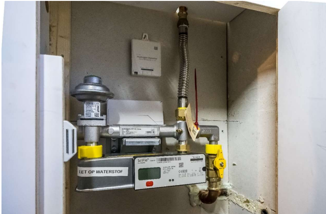
Figuur 8: Voorbeeld van installatie van ultrasonische waterstofmeter en -sensor
